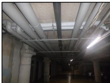
Collecteur cheminant au plafond du sous-sol
