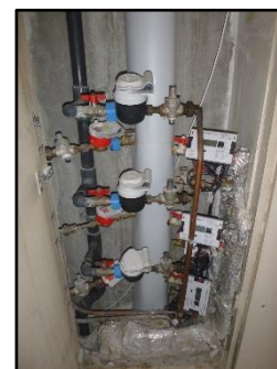
Gaine technique encombrée par les réseaux de chauffage, d'ECS d'eau froide et leurs compteurs
